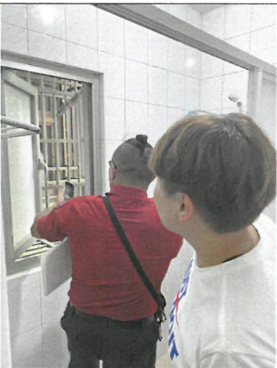
浴室電熱水器強排檢查
