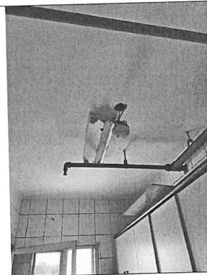
廚房的住宅用火災警報器
