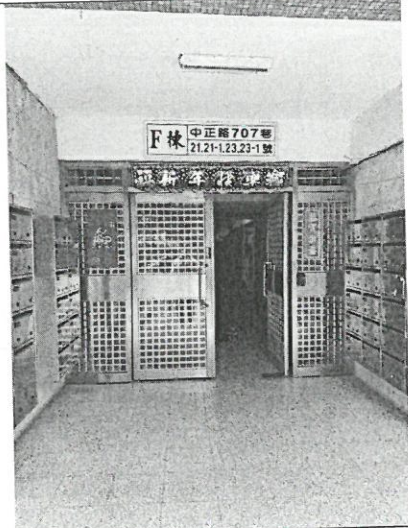
大門口感應及監視器設備
