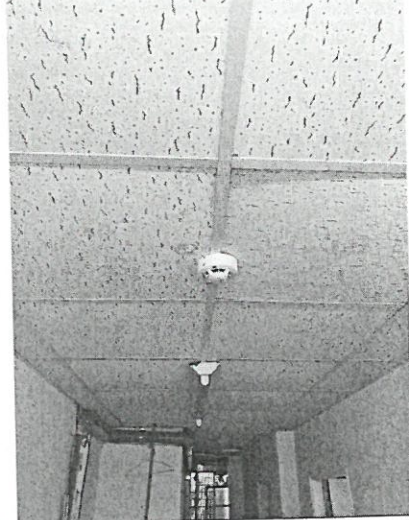
走廊煙霧偵測器
