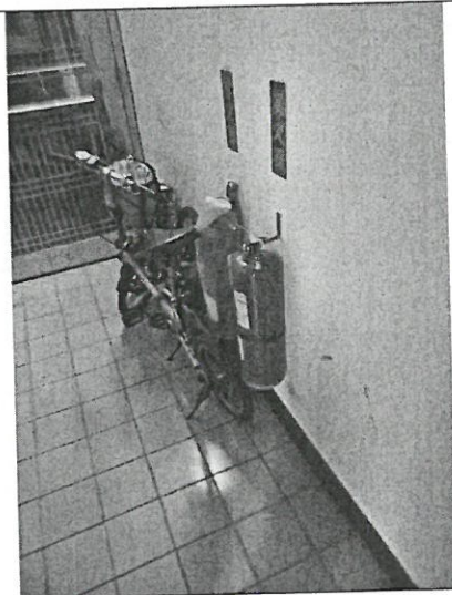
走廊外滅火器
