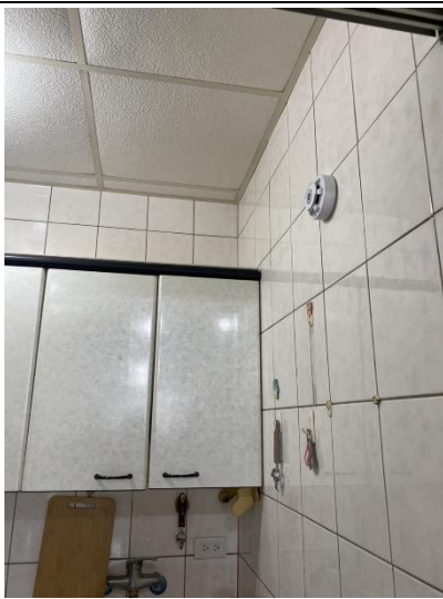
廚房的住宅用火災警報器
