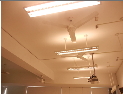
固定式電扇 6 個天花板
