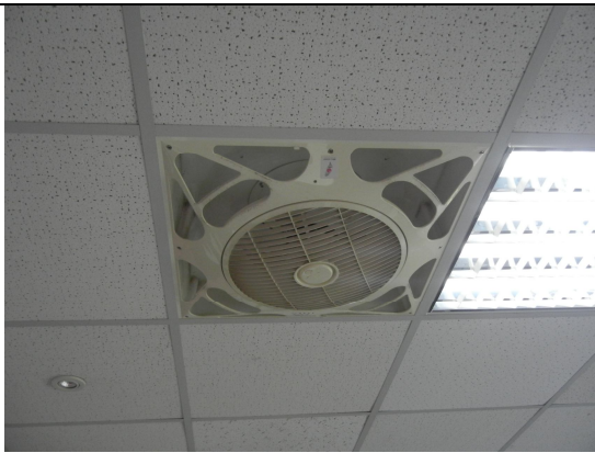
天花板電風扇 4 臺
