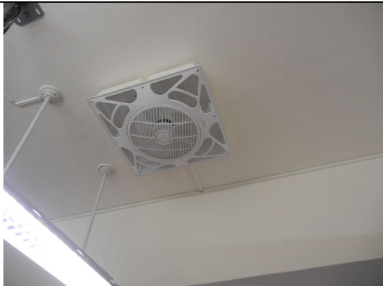
天花板電扇 9 臺
