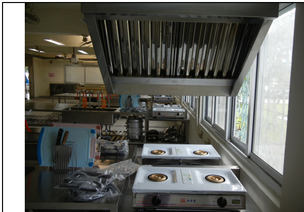
瓦斯爐及抽風機 6 組
