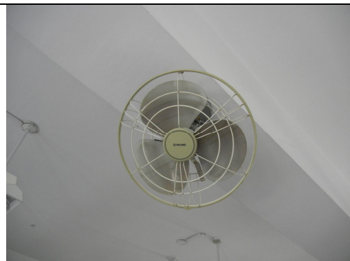
天花板電扇 6 臺
