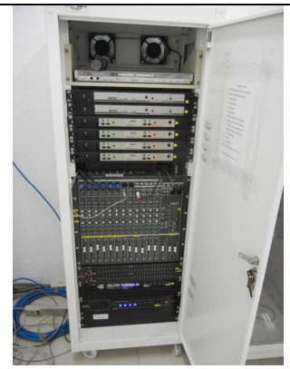
音響設備、電箱
